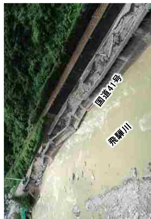
令和2年7月豪雨 国道41号
