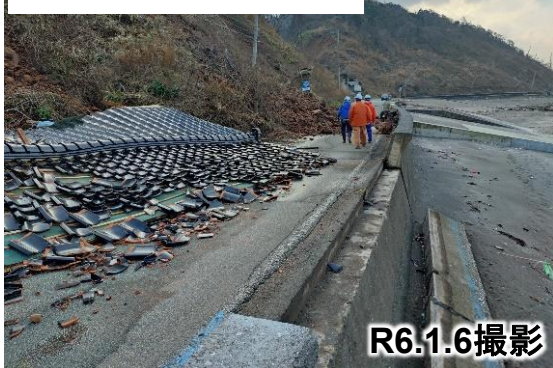
崩落箇所 着工前
