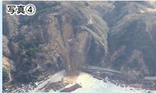
国道249号法面崩落
