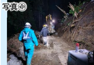
県道38号被災状況
