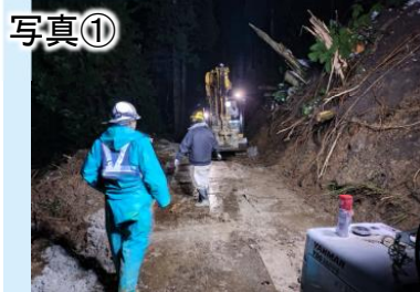
県道38号被害状況
