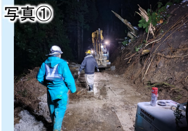
県道38号被災状況
