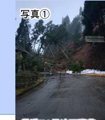
県道51号法面崩落
