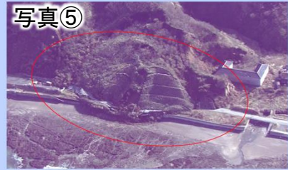
国道249号法面崩落
