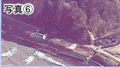
国道249号法面崩落
