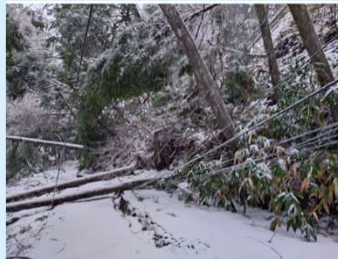
県道38号被害状況
