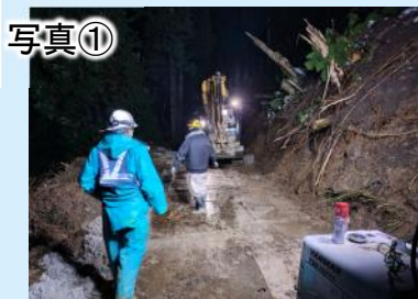
県道38号被災状況
