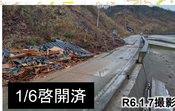
崩落箇所 啓開完了
