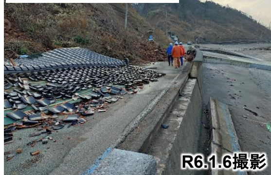
崩落箇所 着工前
