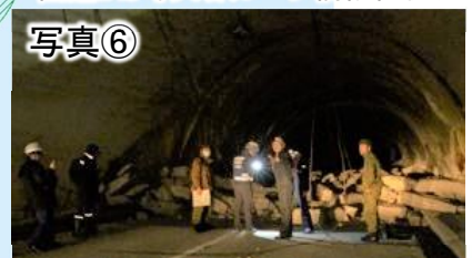
国道249号大谷トンネル崩落状況調査
