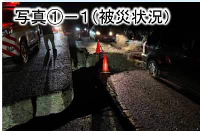
写真①-1 (被災状況)
