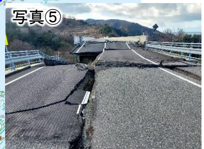
国道249号大谷ループ橋被害状況
