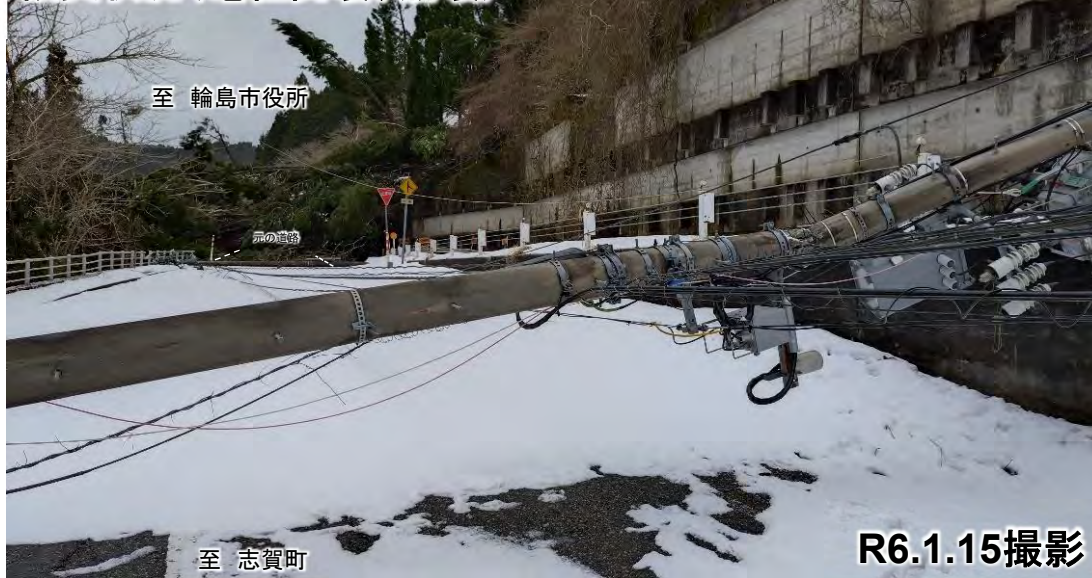
被災状況(電柱倒壊、崩壊)
