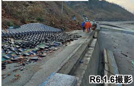
崩落箇所 着工前
