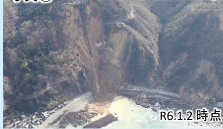
写真④ 国道249号法面崩落
