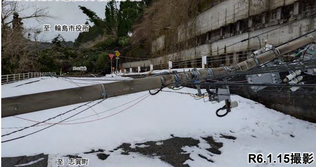
被災状況(電柱倒壊、崩壊)
