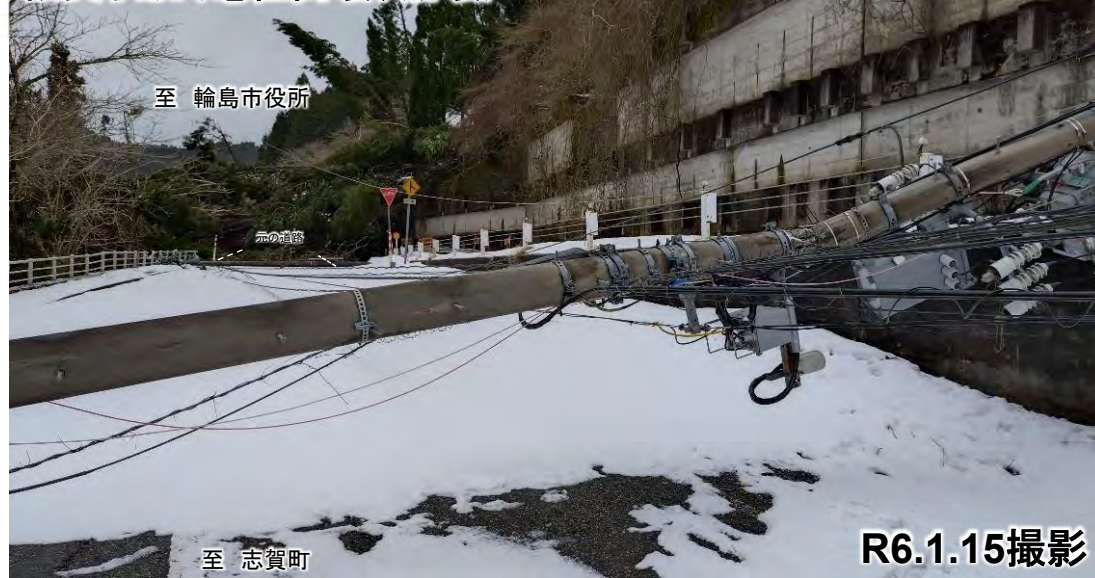
被災状況(電柱倒壊、崩壊)
