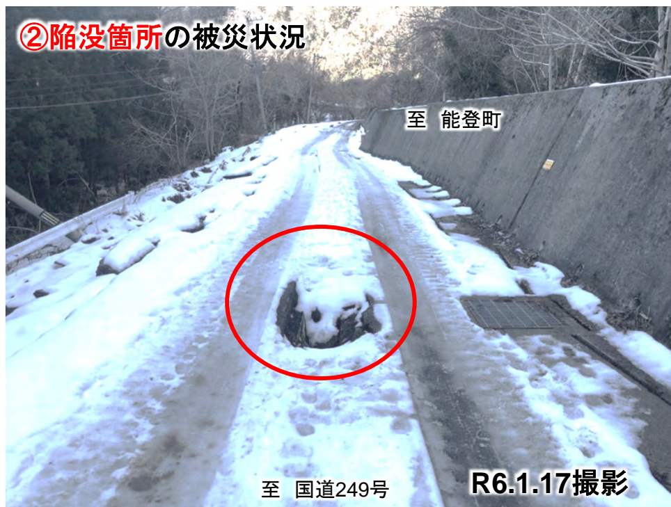
②陥没箇所の啓開後の状況
