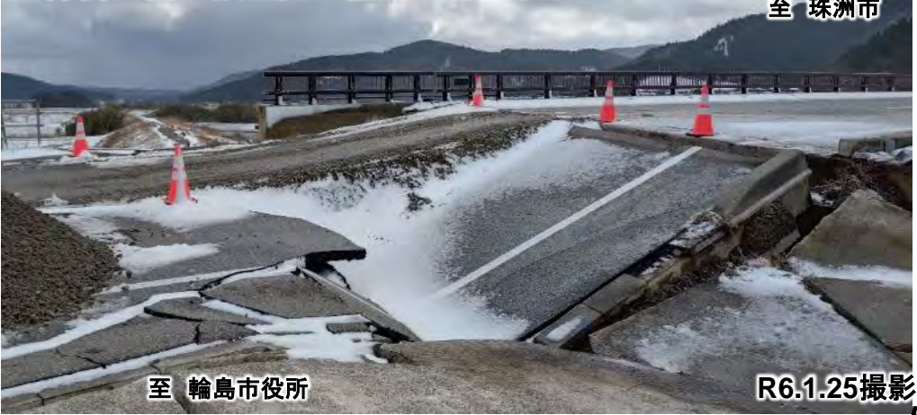
天神橋西側の段差発生箇所の啓開状況
