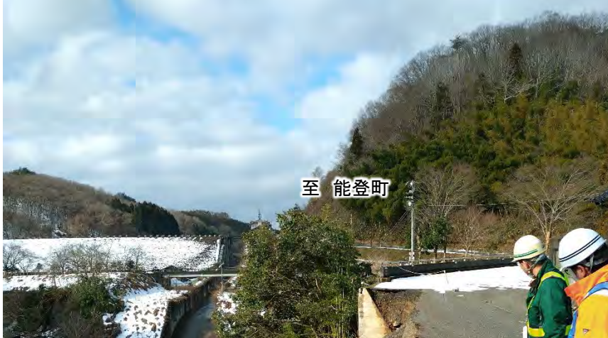
⑫崩落箇所被災状況
