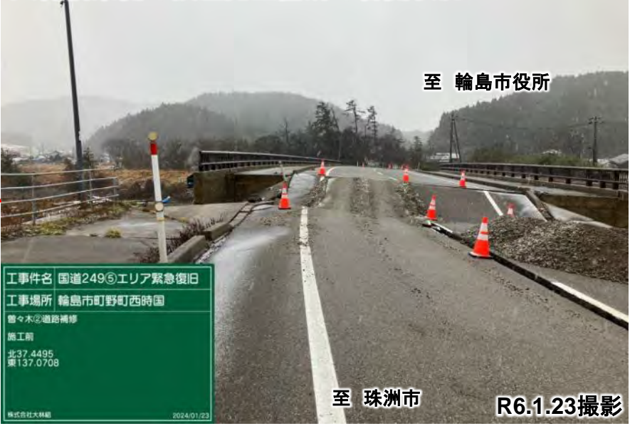
天神橋東側の段差発生箇所の啓開状況
