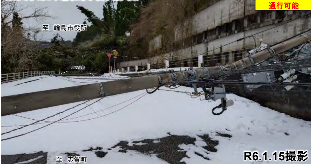
被災状況(電柱倒壊、崩壊)
