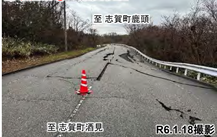
崩壊箇所①の被災状況
