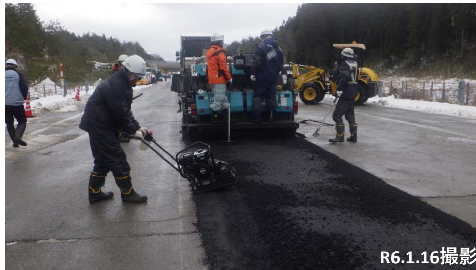
No.6 路面亀裂、段差復旧状況
