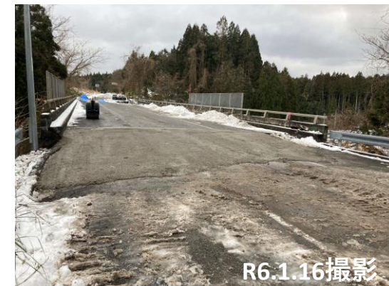
No.51 段差擦り付け
