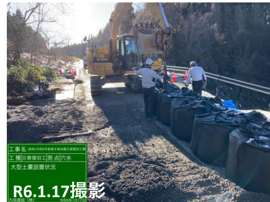
No.51 段差擦り付け
