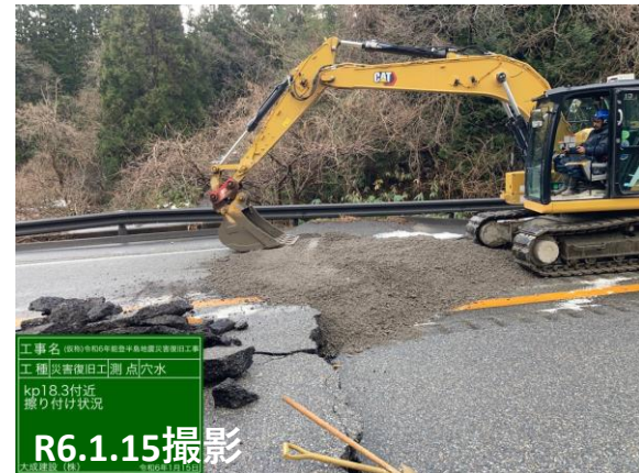
No.56 段差擦り付け
