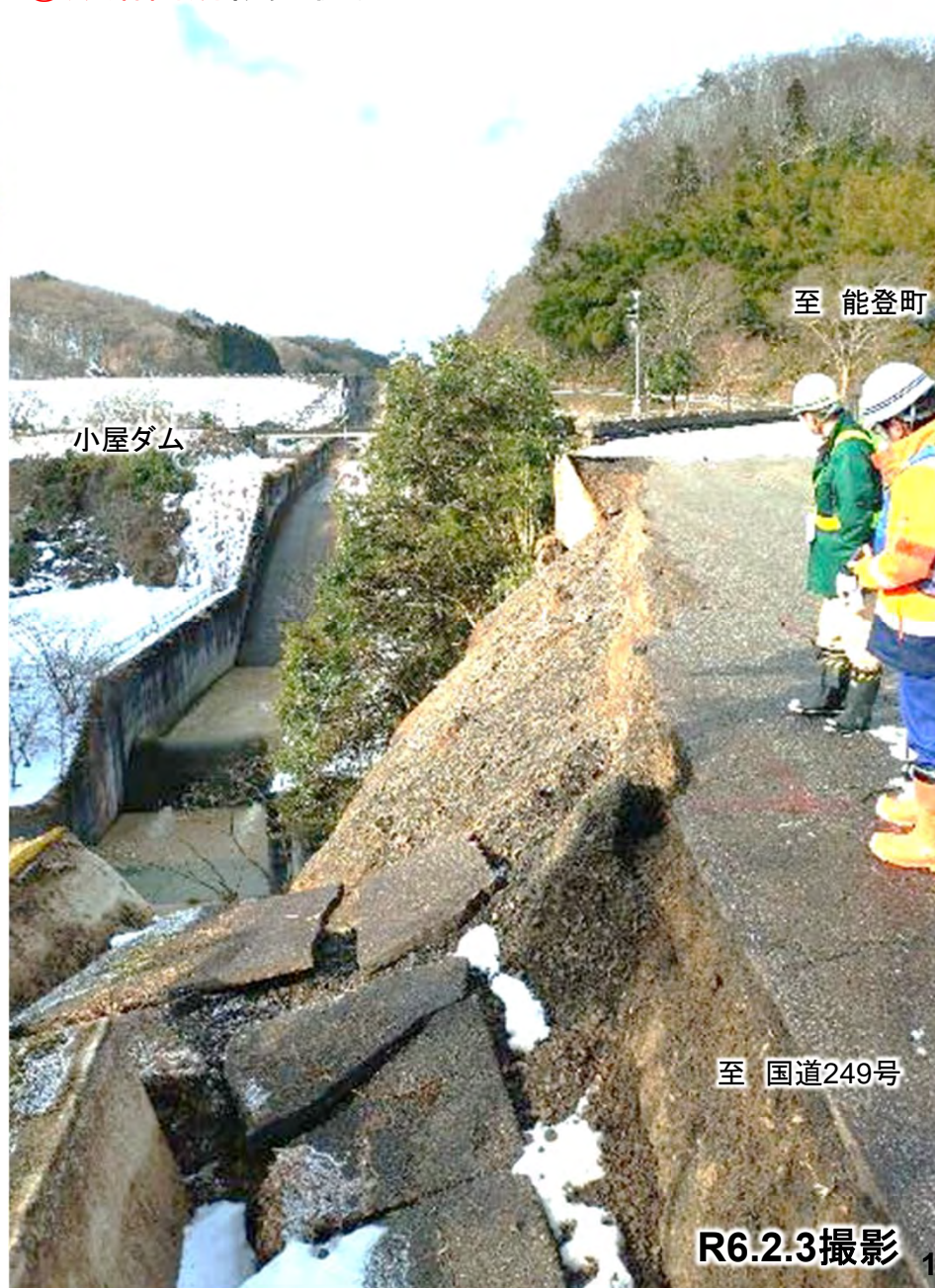
⑪崩落箇所被災状況
