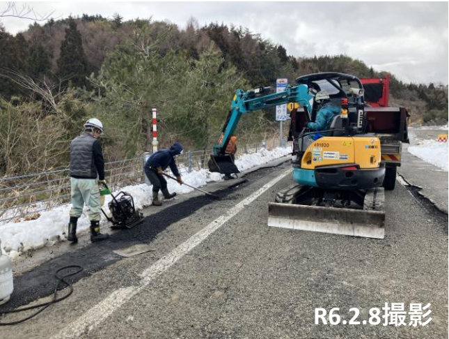
No.4付近 亀裂・段差補修状況
