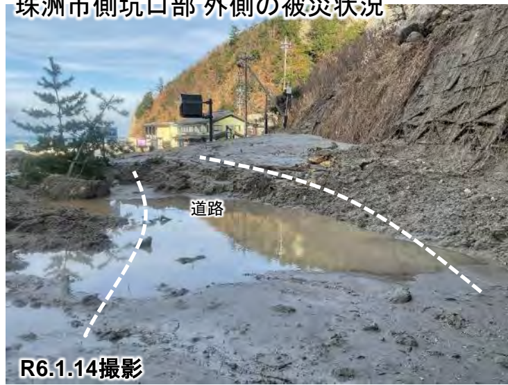
八世乃洞門新トンネル 珠洲市側坑口部 外側の被災状況
