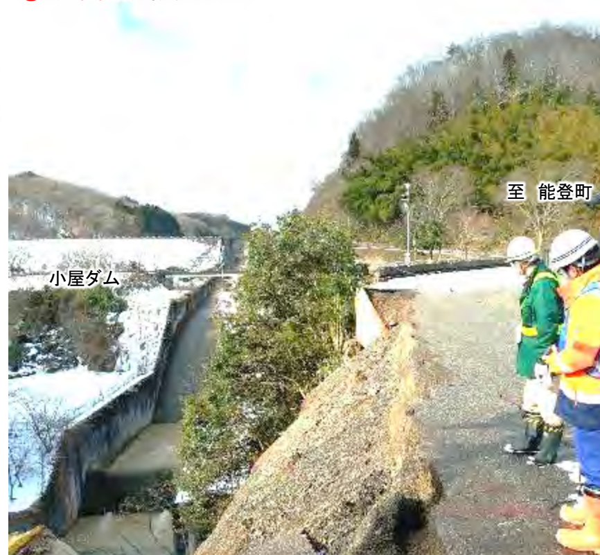
⑪崩落箇所被災状況
