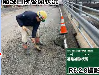
陥没箇所啓開状況
