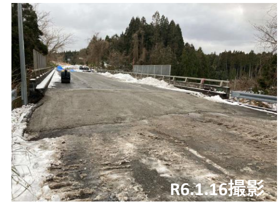
No.51 段差擦り付け
