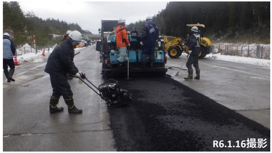
No.6 路面亀裂、段差復旧状況
