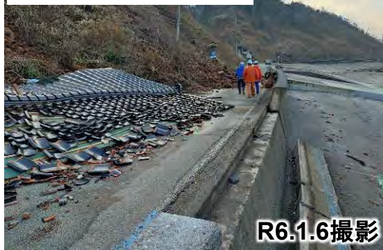
崩落箇所 着工前
