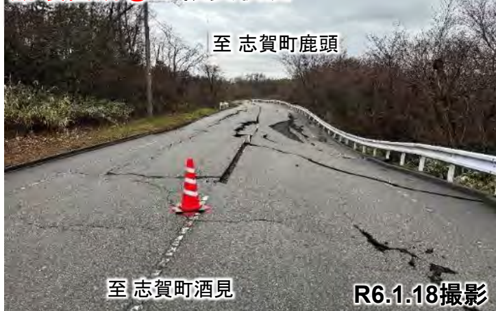
崩壊箇所①の被災状況
