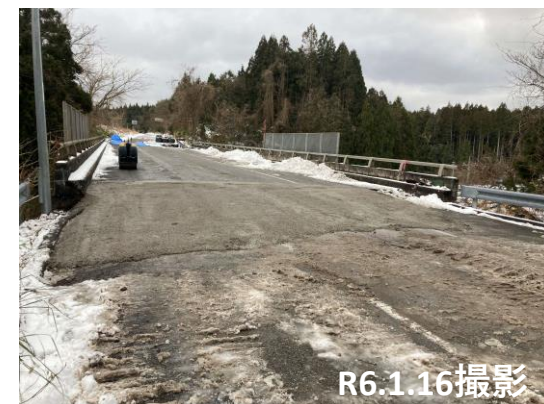
No.51 段差擦り付け
