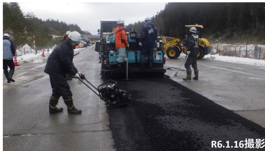
No.6 路面亀裂、段差復旧状況
