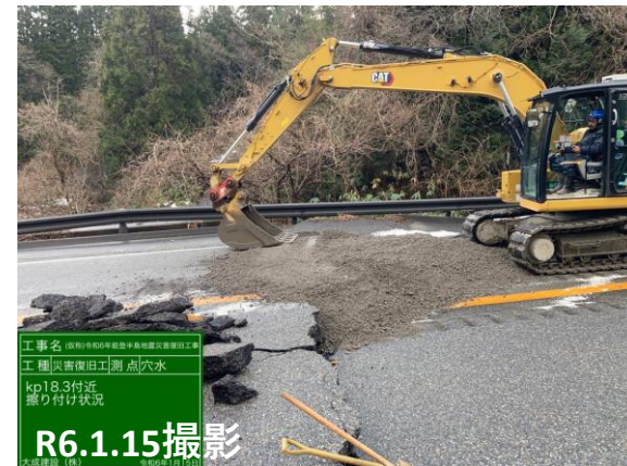
No.56 段差擦り付け
