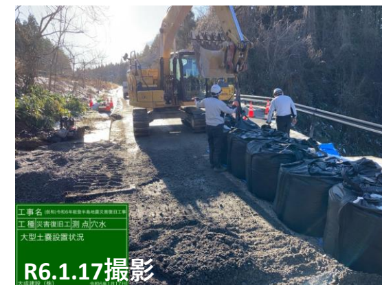
No.51 段差擦り付け
