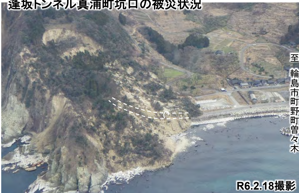
逢坂トンネル真浦町坑口の被災状況
