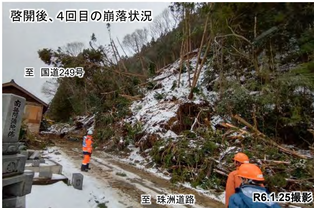
啓開後、4回目の崩落状況
