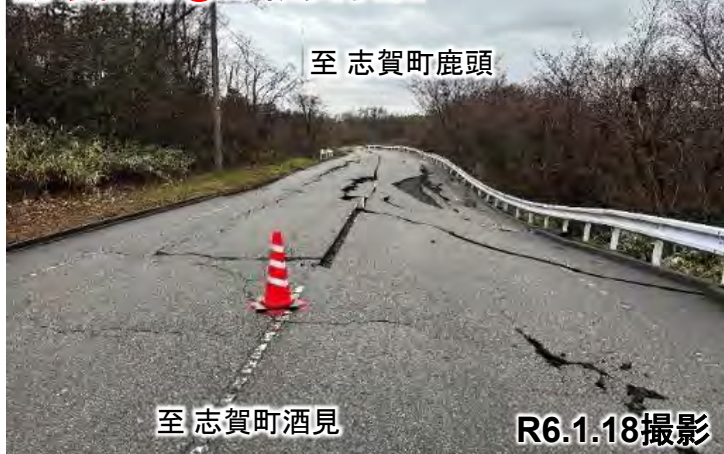
崩壊箇所①の被災状況
