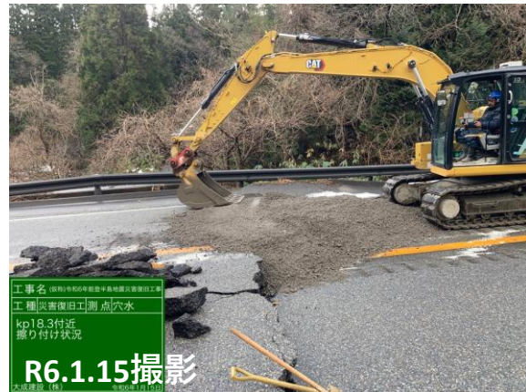
No.56 段差擦り付け
