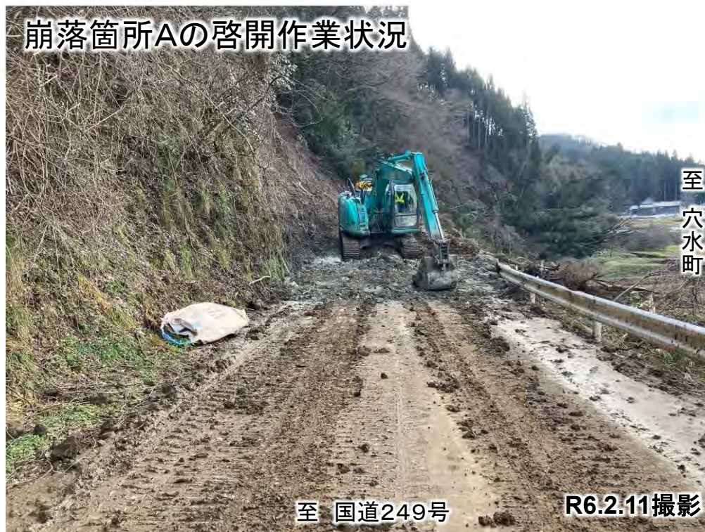
崩落箇所Aの啓開後の状況
