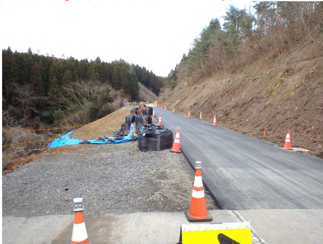
崩落箇所③の啓開後、志賀町による舗装工事後の状況
