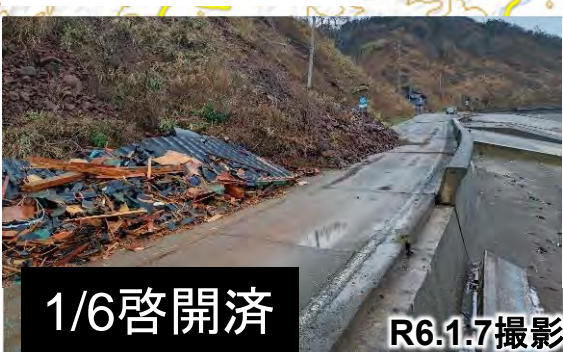
崩落箇所 啓開完了
