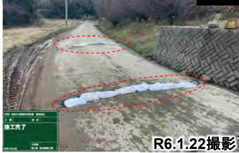
舗装損傷箇所を啓開状況 啓開済
