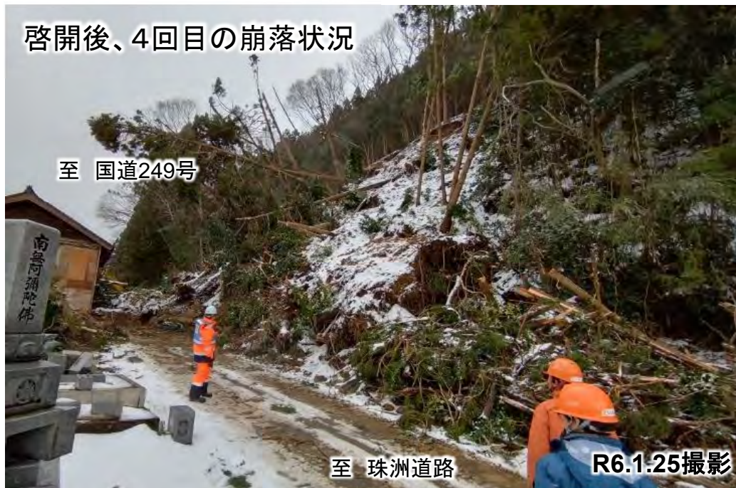
啓開後、4回目の崩落状況
