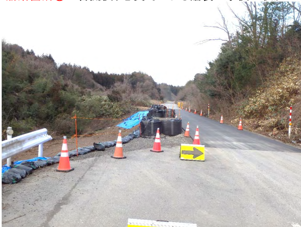
崩落箇所②の啓開後、志賀町による舗装工事後の状況
