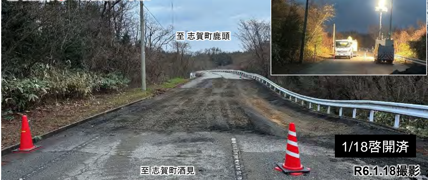
崩壊箇所①の啓開後の状況
