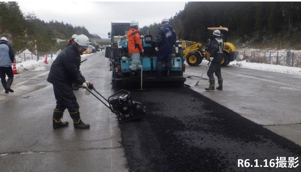
No.6 路面亀裂、段差復旧状況
