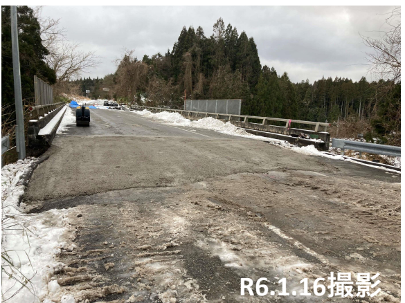
No.51 段差擦り付け
