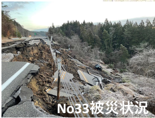
No.2被災状況
