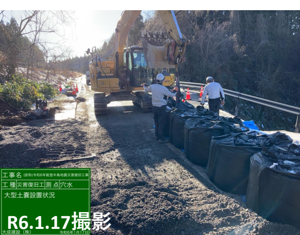
No.51 段差擦り付け
