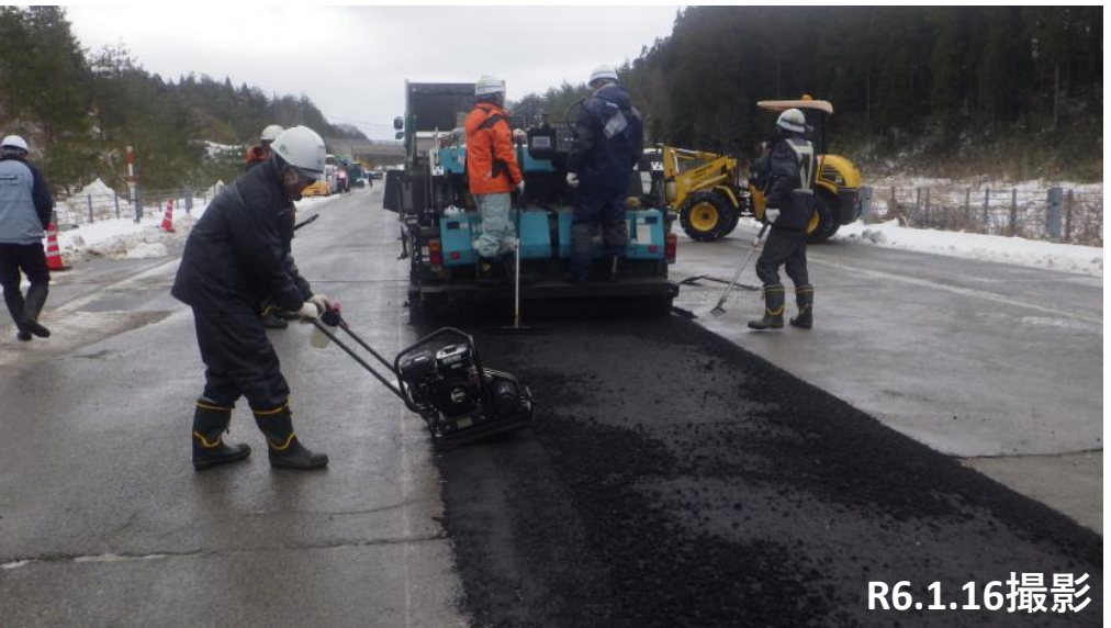
No.6 路面亀裂、段差復旧状況
