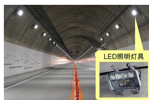
道路照明のLED化
