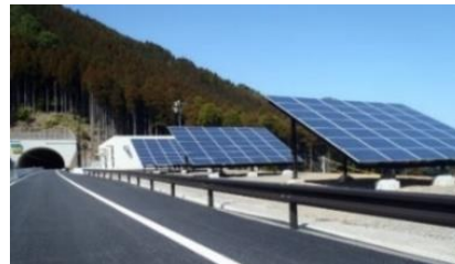
道路空間の太陽光発電設備
