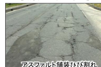
アスファルト舗装ひび割れ
