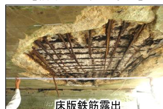
床版鉄筋露出
