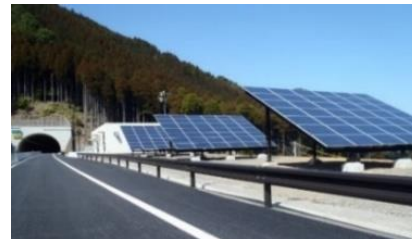
道路空間の太陽光発電設備
