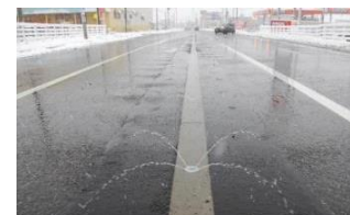
消融雪施設等の整備
