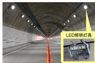
道路照明のLED化
