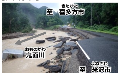
国道121号 令和4年8月の大雨
