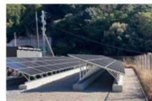
道路空間の太陽光発電設備
