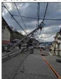
電柱等の倒壊
