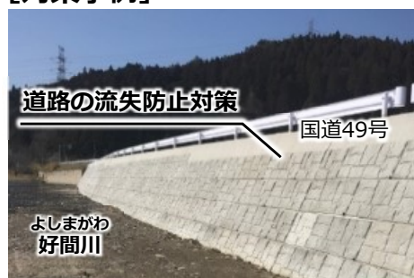
国道49号の道路流失対策（福島県いわき市）
