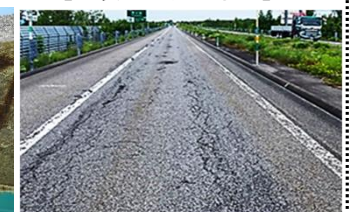
アスファルト路盤の損傷
