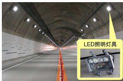
道路照明のLED化
