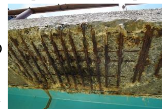
床版鉄筋の露出
