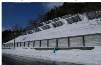
雪崩対策の例（雪崩防止柵）
