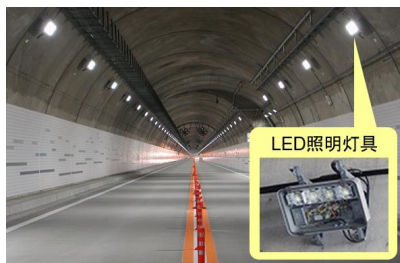
道路照明のLED化
