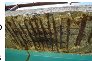
床版鉄筋の露出
