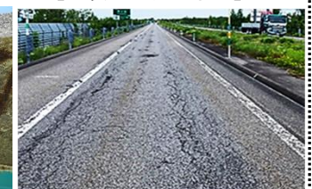
アスファルト路盤の損傷
