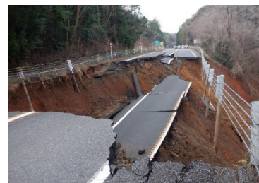
R6能登半島地震による盛土崩落状況
