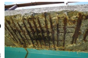
床版鉄筋の露出
