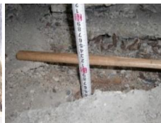
③コンクリートの損傷
