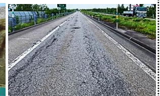
アスファルト路盤の損傷
