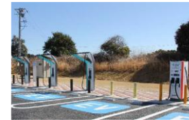
EV充電施設
