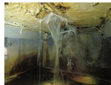
①トンネル内の漏水
