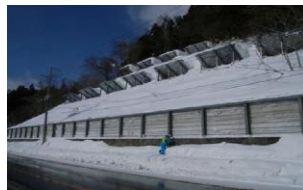
雪崩対策の例(雪崩防止柵)
