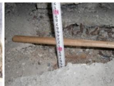
③コンクリートの損傷
