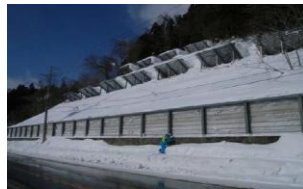
雪崩対策の例(雪崩防止柵)
