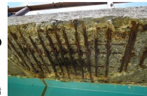
床版鉄筋の露出
