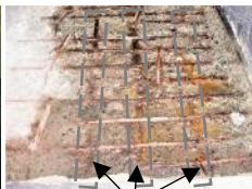
②鉄筋一部消失
