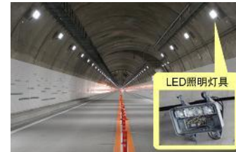
道路照明のLED化
