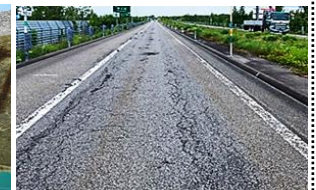
アスファルト路盤の損傷
