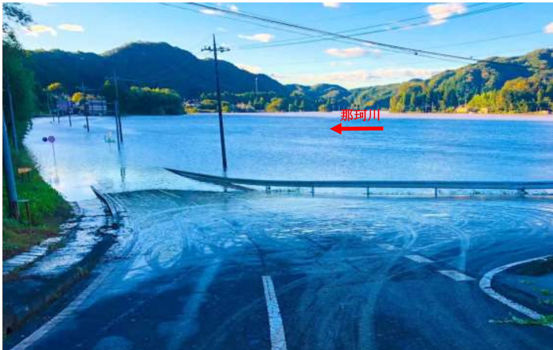
① 令和元年 10 月 13 日 県道那須・黒羽・茂木線 冠水状況 しもざかいに じ 下 境 尼 寺 地区
