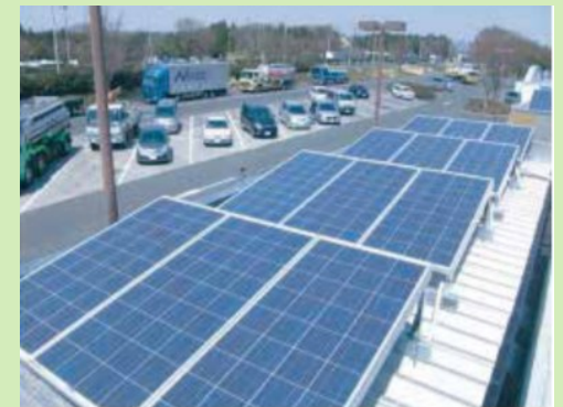
道路空間における脱炭素化施設の導入促進 (写真は太陽光発電施設)
